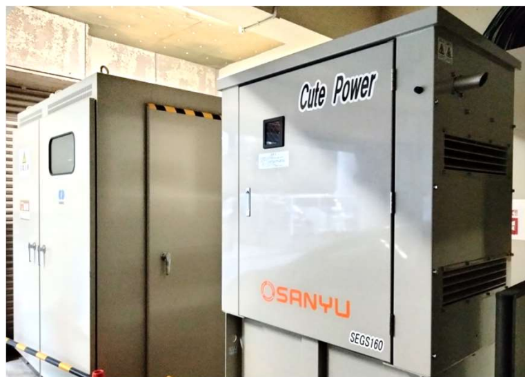
小型非常用発電装置(本社/2023年4月に導入)
